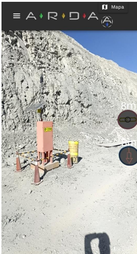
Imagen 8. Piezómetro en terreno e Íconos Flotantes de los sensores de cuerda (fuente: creación propia).
